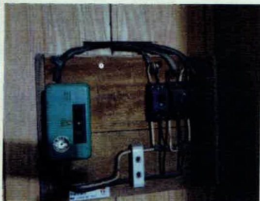
木造型(電線がむき出しのもの)
